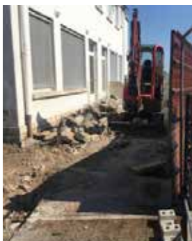
Destruction du parvis côté cour école maternelle, le 26/08
